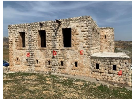
Joint discharge (a), Cement use (b, c), Surface loss (d)
